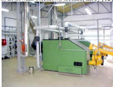
a) kotłownia osiedlowa średniej mocy [12]
